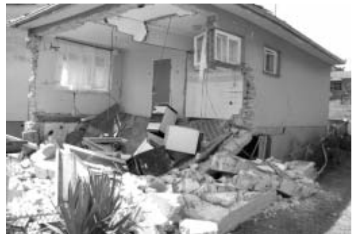
ВЕЛИКА ОШТЕЋЕЊА НА КУЋИ ОД ЕКСПЛОЗИЈЕ
