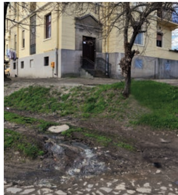
ЗБОГ ЗАПУШЕНЕ ЦЕВИ КАНАЛИЗАЦИЈА СЕ ИЗЛИВА НИЗ УЛИЦУ
