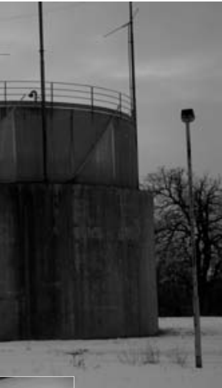
РЕЗЕРВОАР БИОГАСА И ГЕНЕРАТОР ЗА ПРОИЗВОДЊУ СТРУЈЕ
